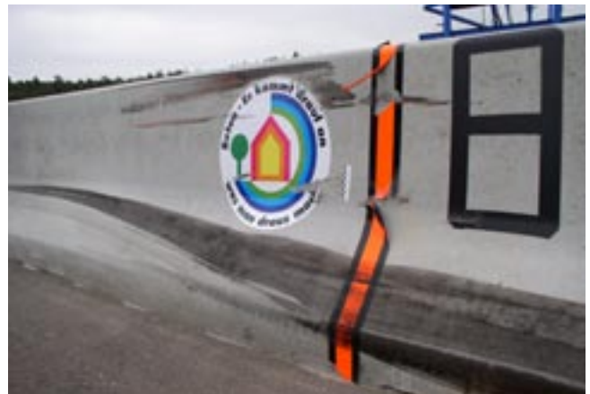
Bild 7: Betonschutzwand nach der Anfahrdeemonstration mit einem Lkw: Reifenabrieb und geringfügige Kratzspuren
