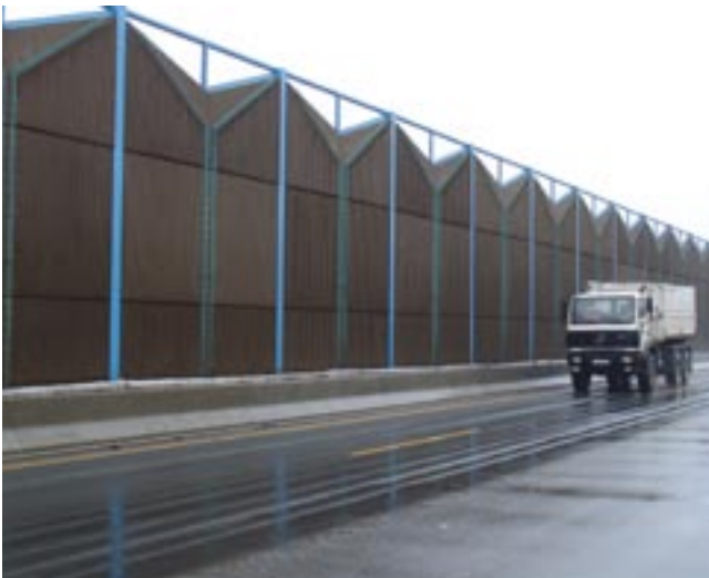
Bild 4: Geringe Wirkungsbereiche von Betonschutzwänden sichern z.B. dahinterstehende Lärmschutzwände vor Beschädigungen
