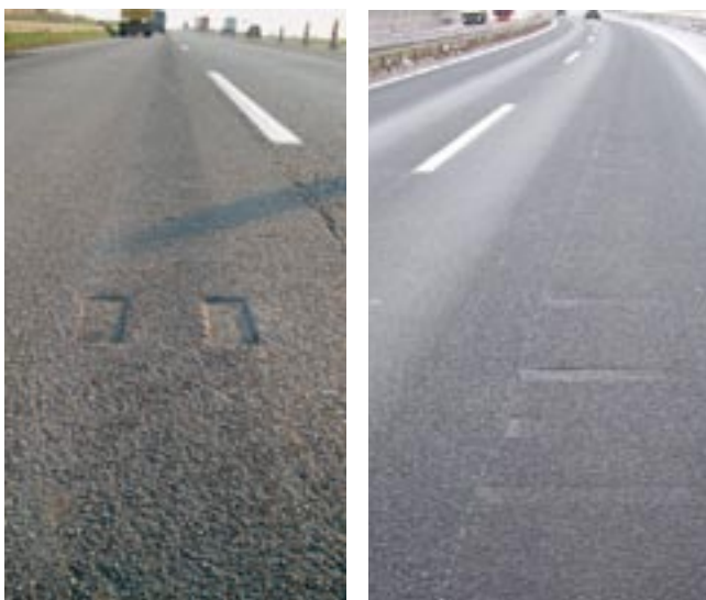
Bild 1 und Bild 2: Eindrückungen von transportablen Schutzeinrichtungen mit kleinen Aufstandsflächen Fotos: Nordbeton, Schnorpeil
